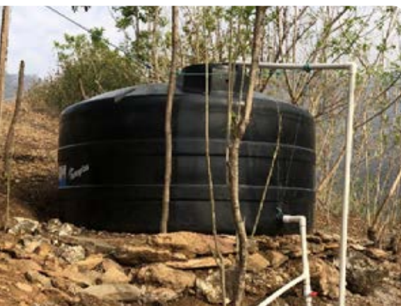
Pozo construido en la Cdad. de Las Minas con ayuda de las parroquias de San Martín y de Jesucristo Resucitado de Vitoria-Gasteiz y tanque desde donde se abastece un sector de 40 familias.
